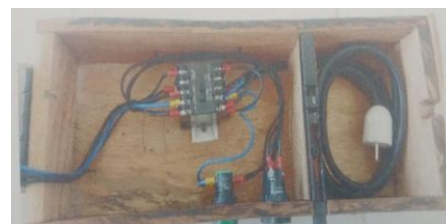
Gambar 6. Ruang rangkaian kendali dan daya
