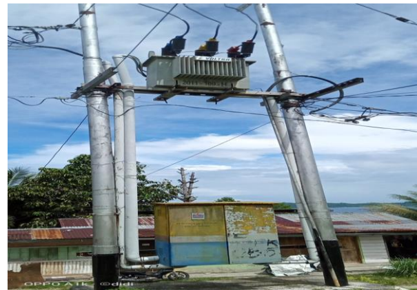
Gambar 1. Gardu distribusi Tipe Voltar Jalan Mambruk Dalam.
